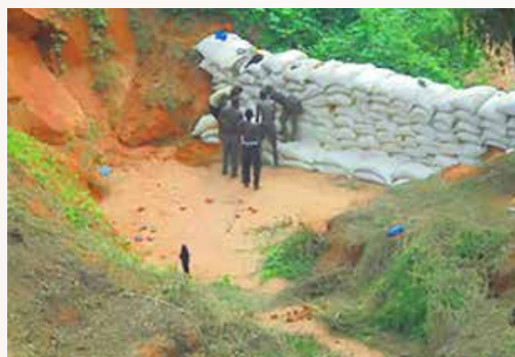
Erection d'une digue à l'aide des sacs de sable au fond du ravin (Déc. 2017)
