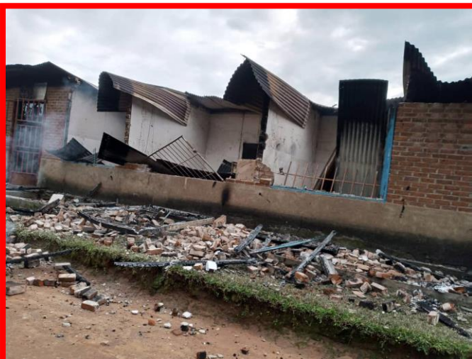
Bâtiment du Centre de Santé de Référence de MABOYA, pillé et incendié, avec des agents tués par les rebelles ADF la nuit du 19 au 20 octobre 2022. ©CARITAS BUTEMBO-BENI.
